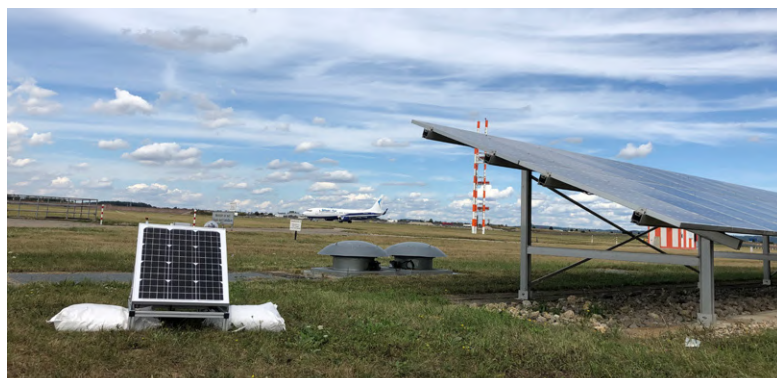
Abbildung 57: Wolkenkamera-system neben der PV-Anlage auf dem Kombispeicher des Flughafens Stuttgart
