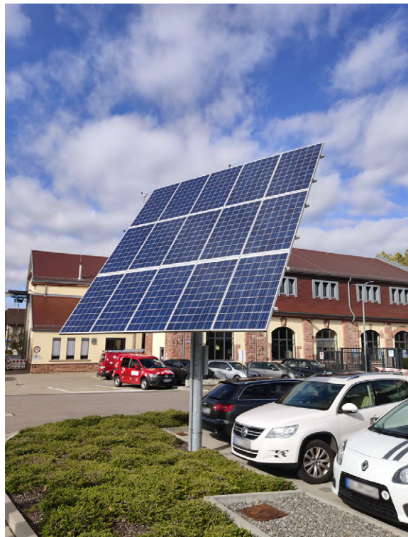
Abbildung 67: Auf dem Gelände des Überlandwerkes Mittelbaden werden Intelligente Messsysteme getestet, um unter anderem Solarenergie besser zu integrieren.
