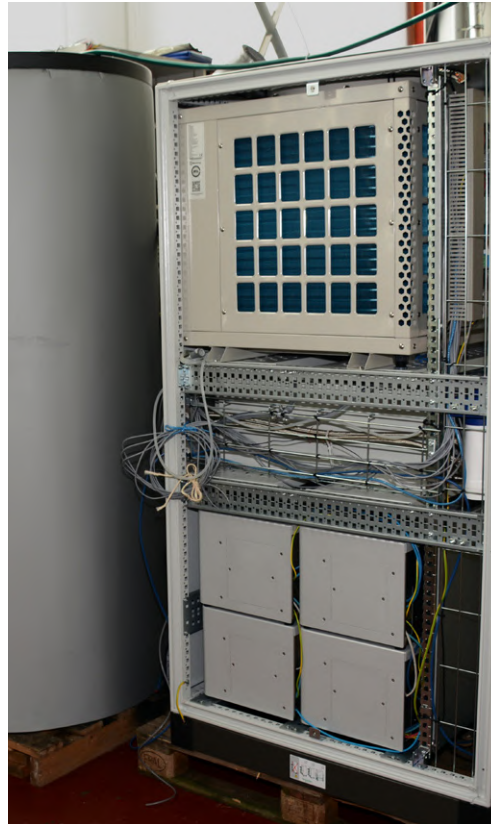
Abbildung 56: Geöffnetes Seitengehäuse der „TH-E Box II“ mit rund zwei Meter Aufbauhöhe und einer thermischen/elektrischen Leistung ohne Warmwasserspeicher von rund 17 kW thermisch / 10 kW elektrisch. Links im Bild steht der einen Kubikmeter fassende thermische Warmwasserspeicher. Im rechten Bildteil die Wärmepumpe (oben), die Brennstoffzelle (mitte) und Lithium-Eisen-Phosphat-Ionenbatterien mit Wechselrichter (unten).
