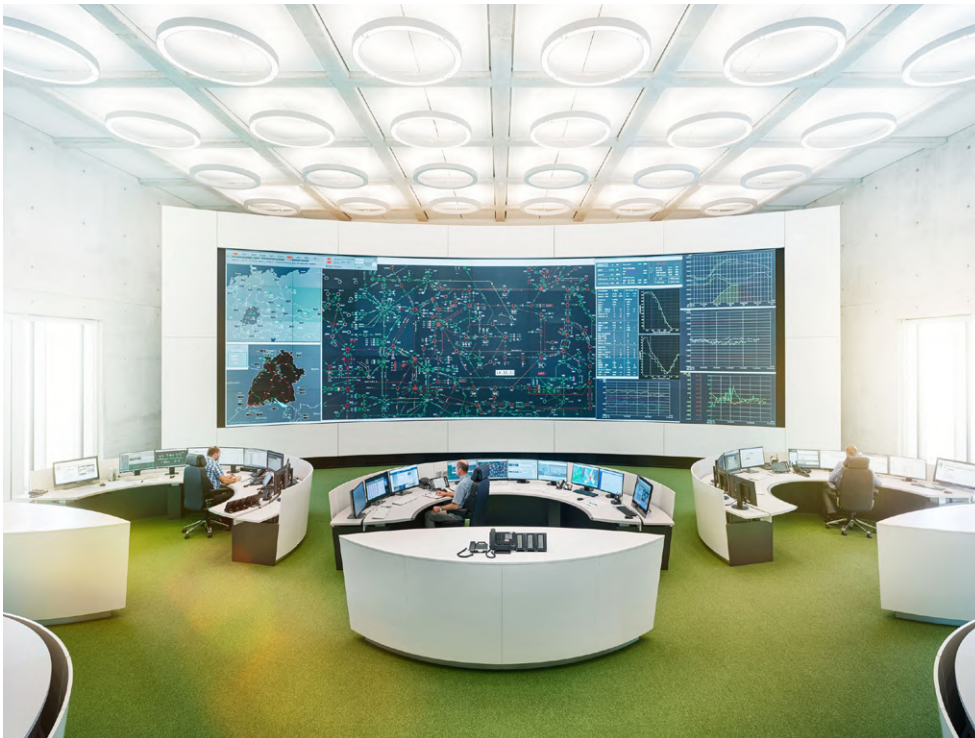
Abbildung 71: Die Hauptschaltleitung Wendlingen des Übertragungsnetzbetreibers TransnetBW.
