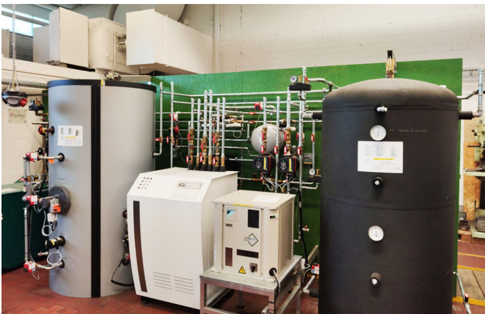
Abbildung 58: Kraft-Wärme-Kopplungsanlage mit Wärmespeicher im Microgrid-Labor der Hochschule Offenburg.
