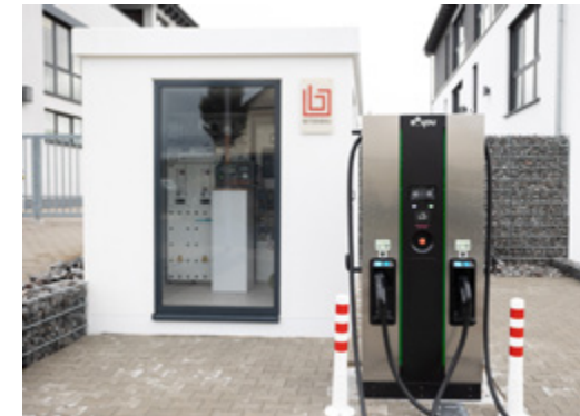
Digitale Ortsnetzstation mit Ladesäule
